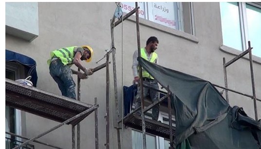
Fotoğraf 8. Manisa'da bir inşaatın dış cephesine kurulan iskele güvenlik önlemi almadan kontrolsüz bir şekilde çalışan işçi
