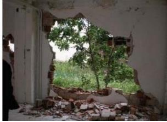
Fotoğraf 3. Marmara depremi, yapısal olmayan dolgu duvar hasarları
