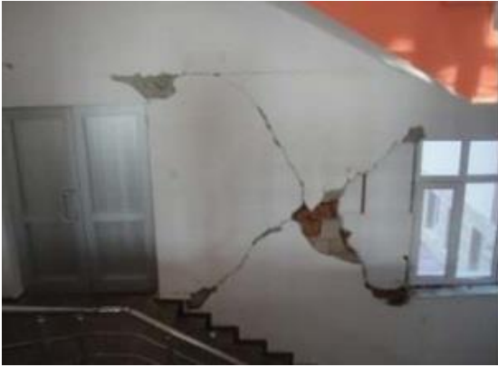
Fotoğraf 2. Marmara depremi, yapısal olmayan dolgu duvar hasarları
