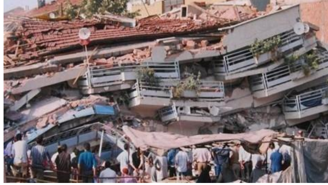
Fotoğraf 4. Gölçük Depreminde Çatısı Sokağa Doğru Yıkılan Yapı
