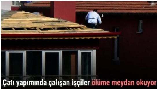
Fotoğraf 7. Kahramanmaraş'ta yapımı devam eden bir çatı üzerinde hiçbir güvenlik önlemi almadan kontrolsüz bir şekilde çalışan işçi
