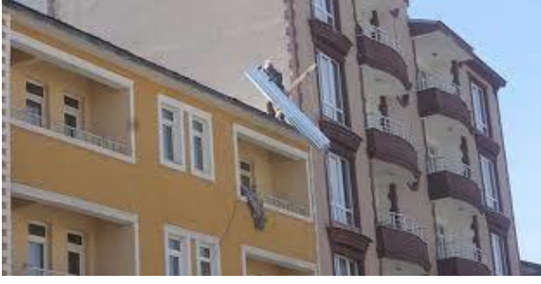
Fotoğraf 9. Ağrı'da çatı ustası çatının üzerine tahtalarla kurduğu makara ile sacları aşağıdan yukarı iple bağlayarak, önlem almadan taşıdı. Hem kendi canını hem de kaldırımdan geçen vatandaşlarının canını tehlikeye attı.
